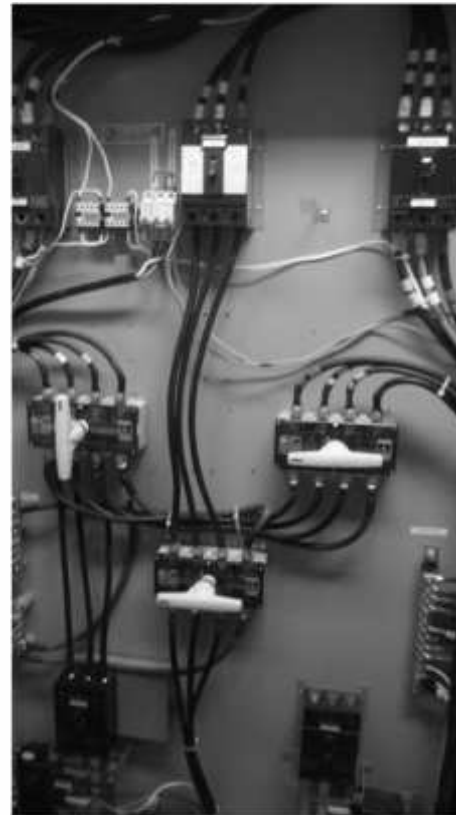
POSIÇÃO DE MANUTENÇÃO NB 02
